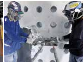
先行コア抜きとハンドクラッシャーによる既存躯体解体状況
